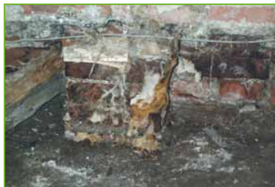
Развитие плесени, грибков и повреждение строительных конструкций.
