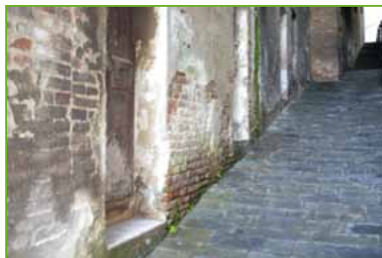
Разрушение штукатурки и растворяемых швов.
