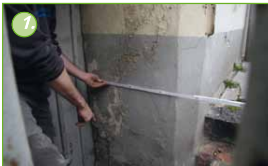
Это кирпичное здание, построенное в 1750 году; сохранившаяся штукатурка повреждена. Содержание соли и влаги в кирпиче высокое.
